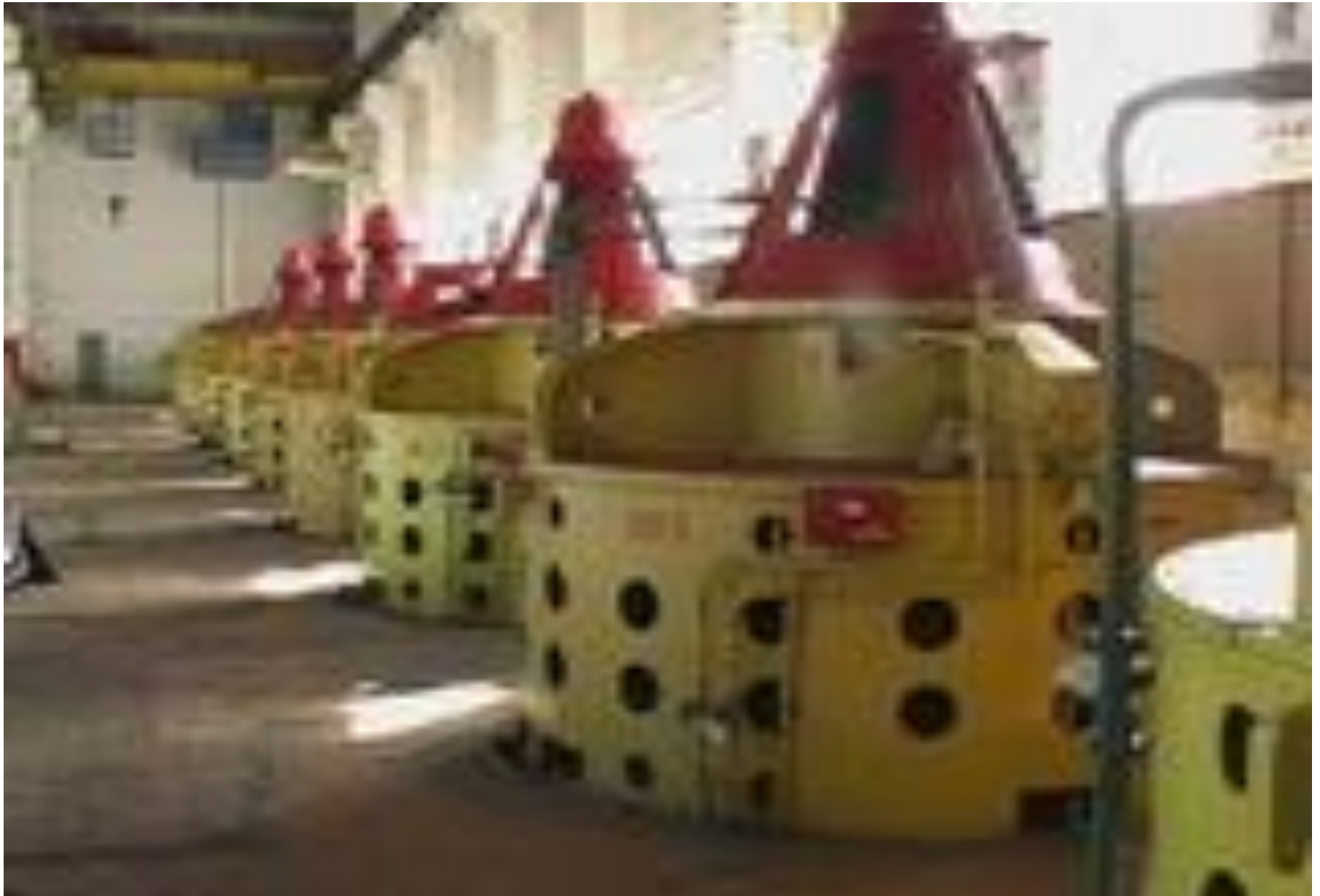
Электродвигатели циркуляционных насосов(ЦН)
