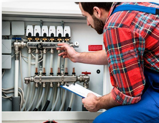
Балансировка системы отопления
