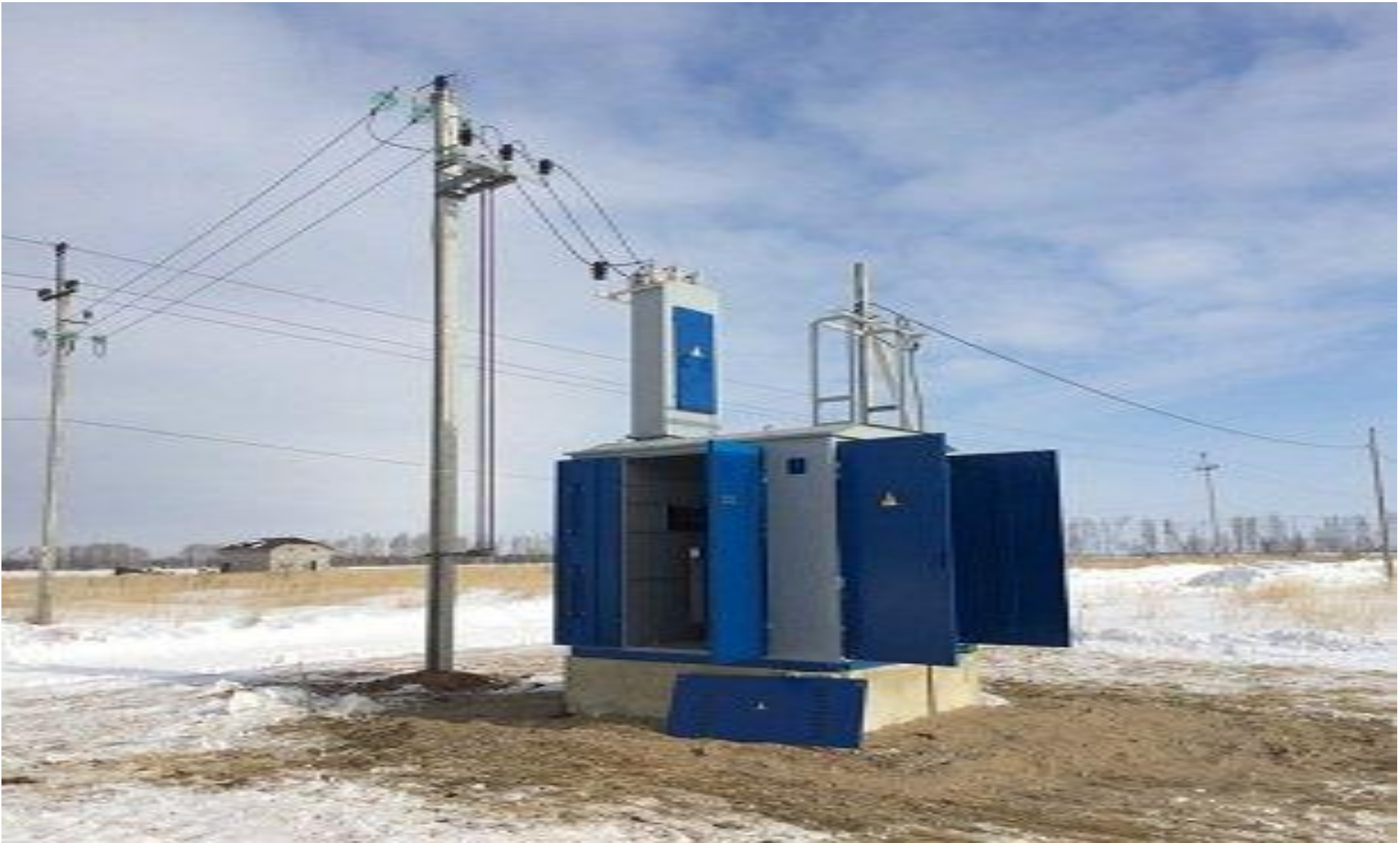
ООО ЭТЗ "Энергорегион" г. Ижевск
