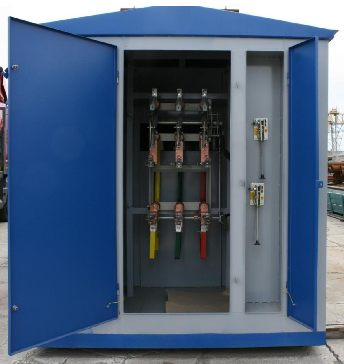
распределительное устройство высокого напряжения 10 кВ
