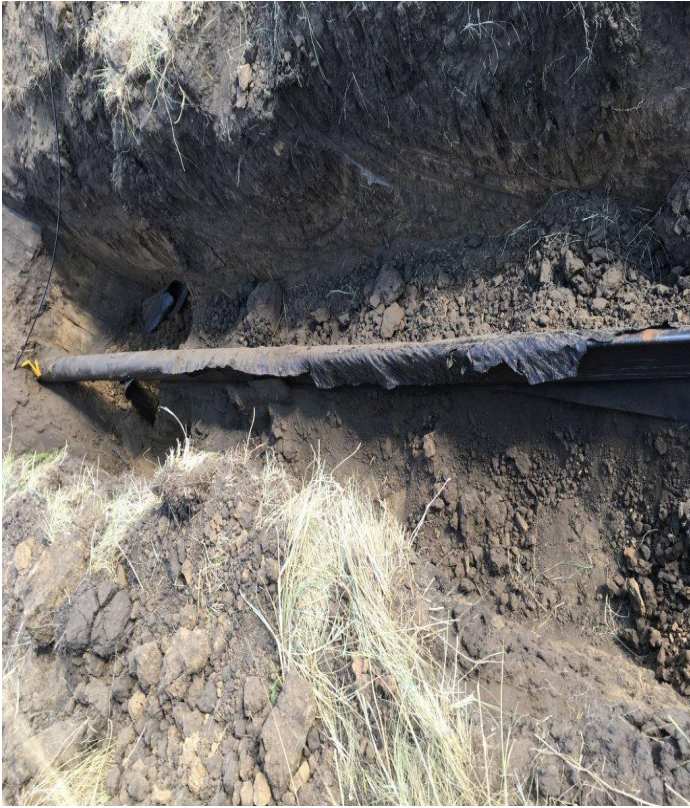
Повреждение стального газопровода
