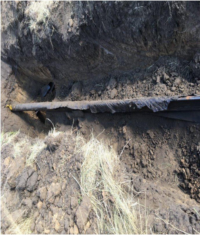
Повреждение стального газопровода
