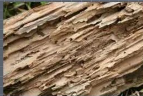
Пример разрушения термитами
