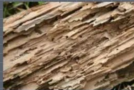
Пример разрушения термитами
