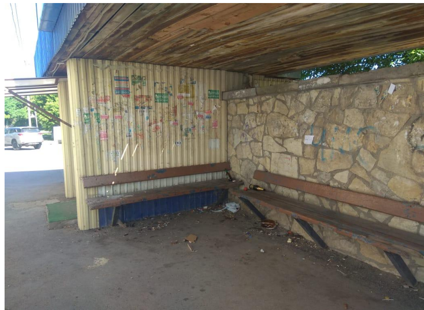
ООТ ул. Революционная (отсутствует урна, мусор)
