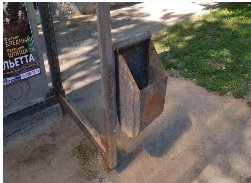
ООТ Президент Отель (неудовлетворительное состояние урны)
