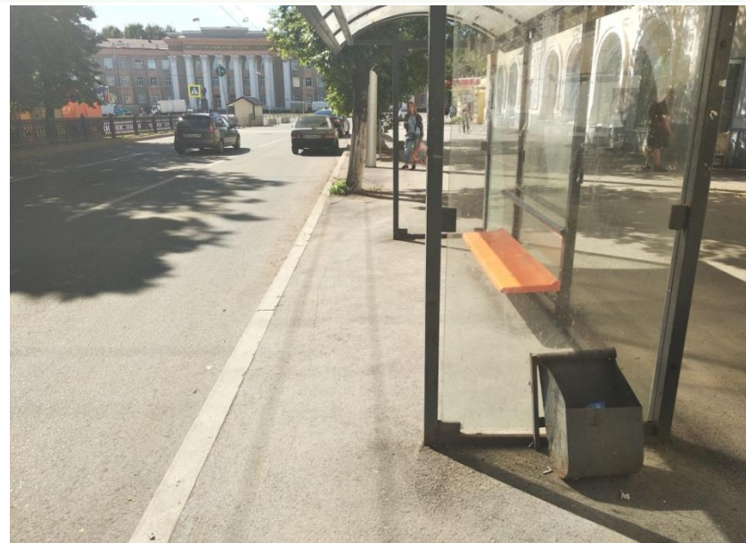
ООТ пл. им. С. Орджоникидзе (неудовлетворительное состояние урны)
