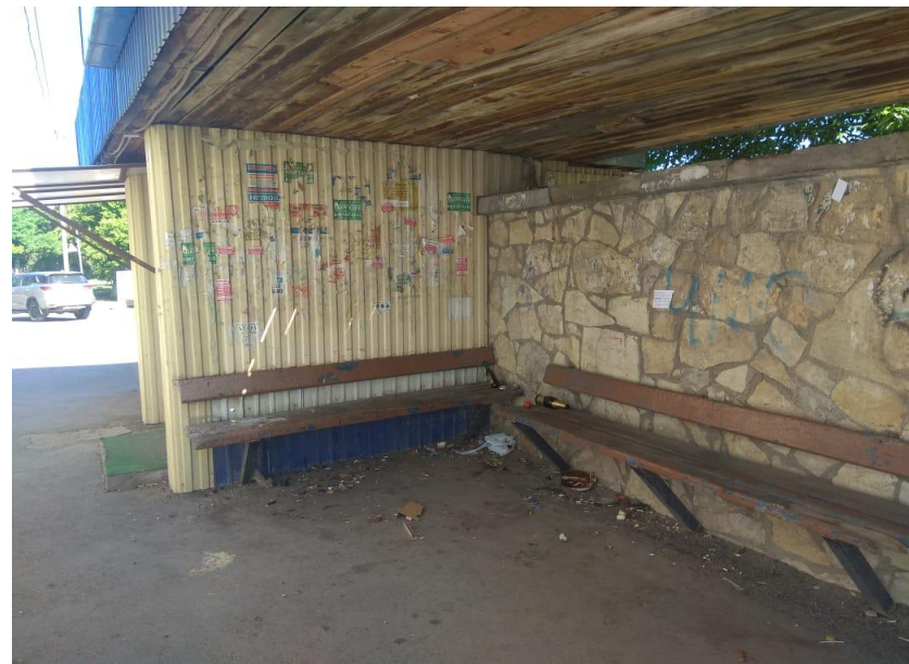
ООТ ул. Революционная (отсутствует урна, мусор)
