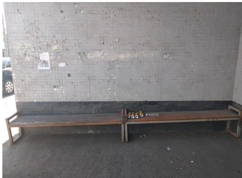
ООТ Заводоуправление УМПО (отсутствие урны, мусор)
