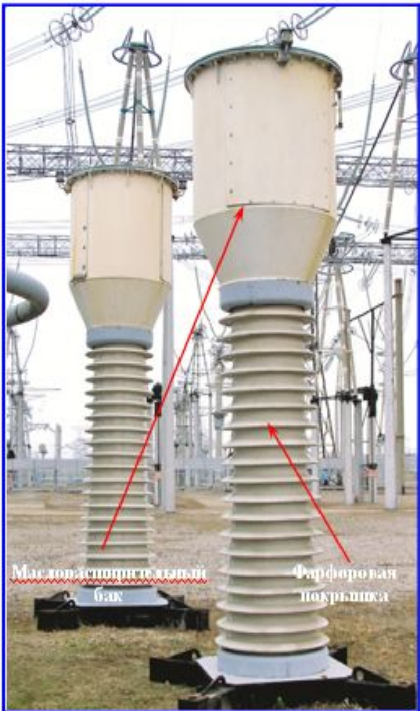
Трансформатор ТФРМ-750 (нижний каскад)
