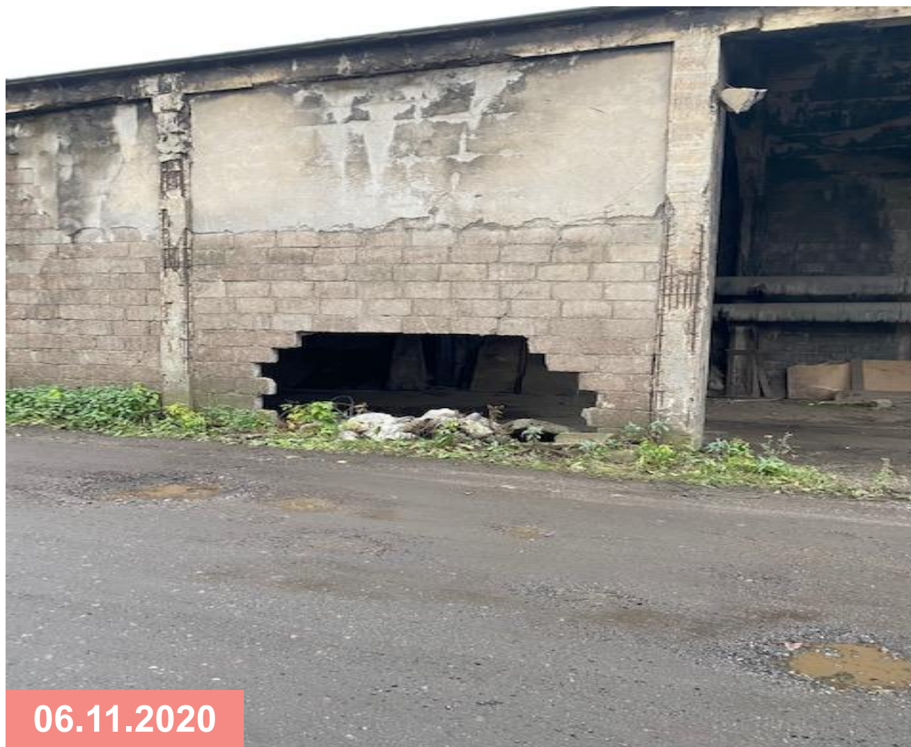
Обрушена стена склада, место не ограждено.
