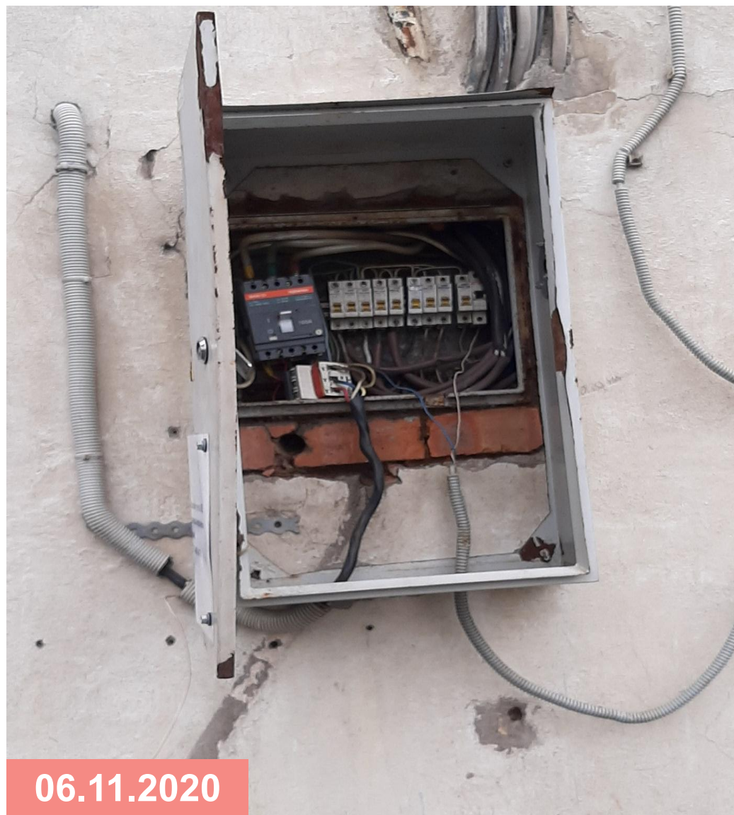
Открытый электроцит в отсеке склада. Автоматические выключатели частично не закреплены.
