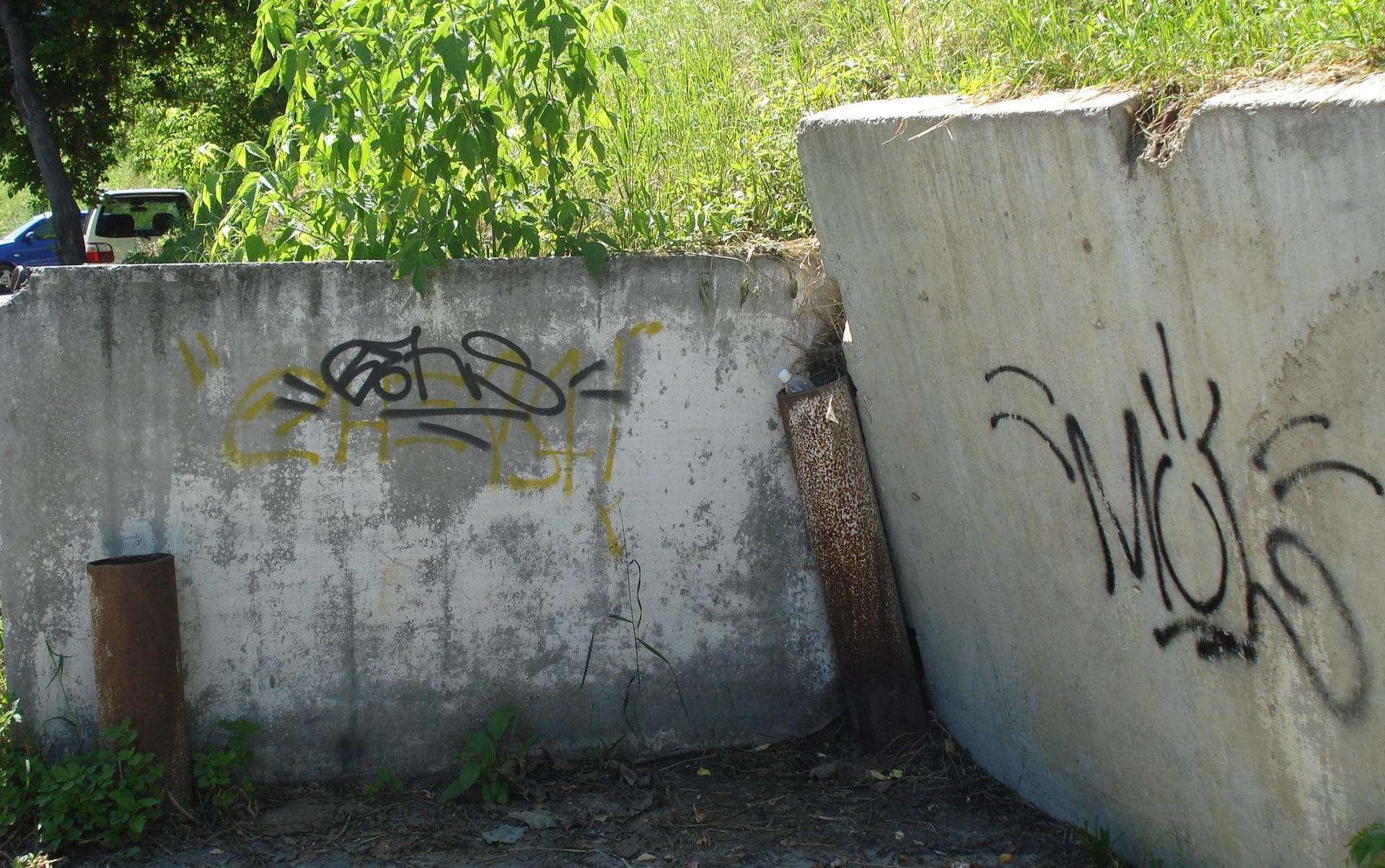
Рисунок 25 Подпорные стенки испытывают колоссальную нагрузку
