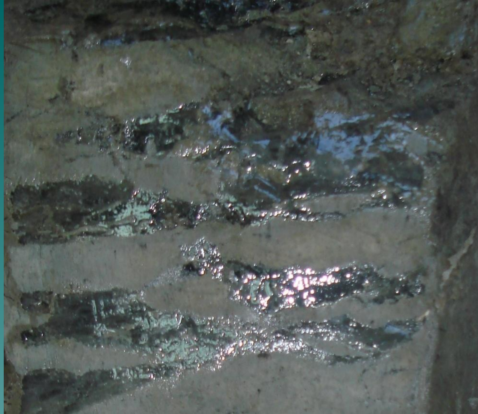
Рисунок 1 Лёд в трещинах
