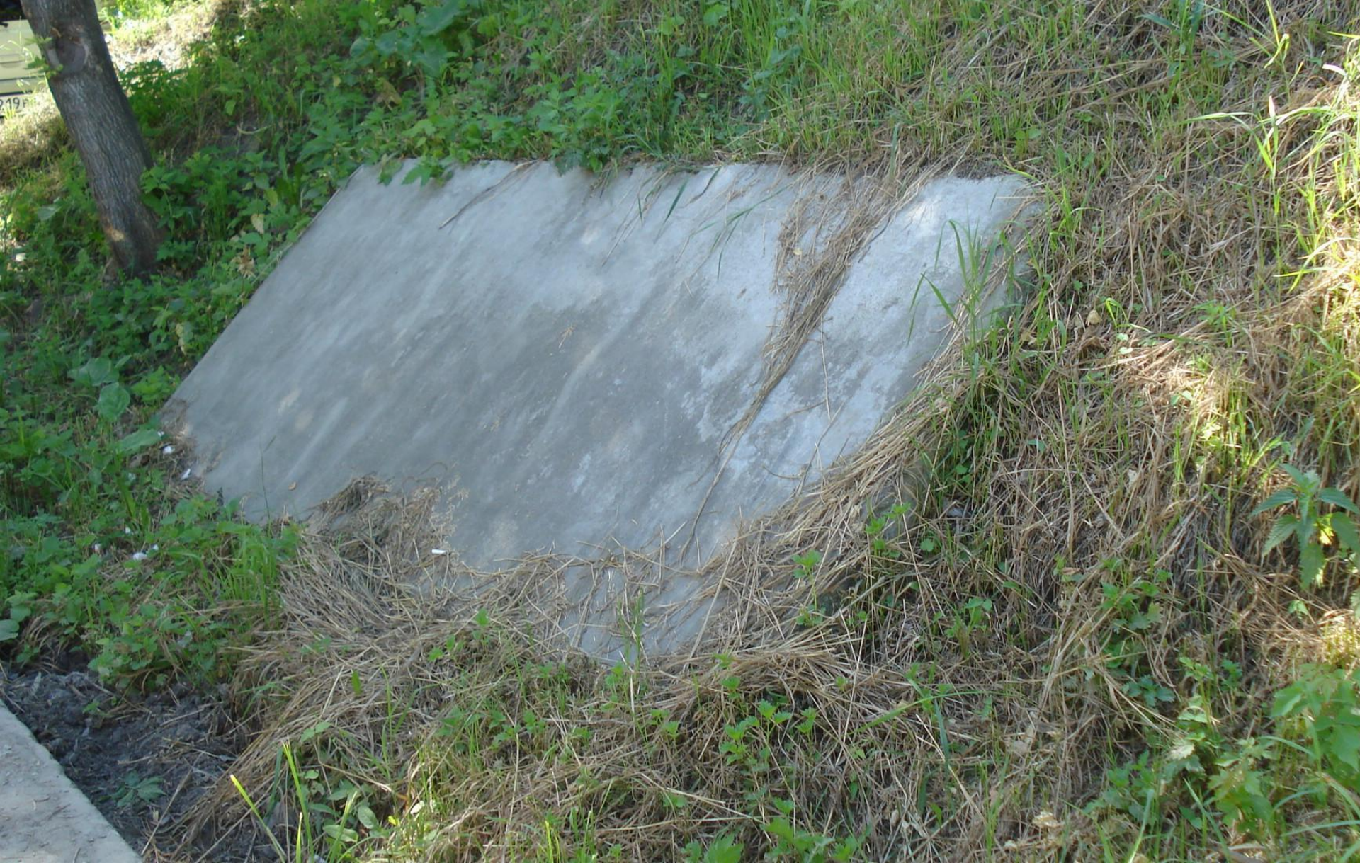
Рисунок 26 Железобетонная плита замедляет оползание грунтов
