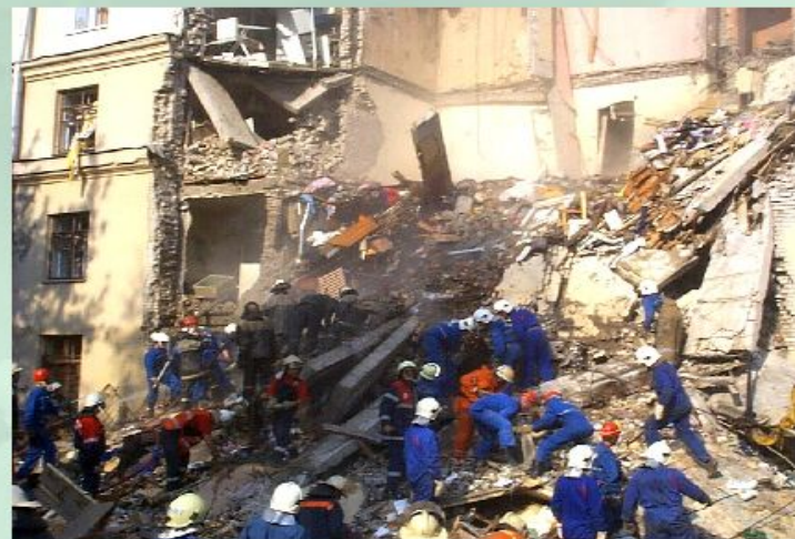
Обрушение жилого дома.
