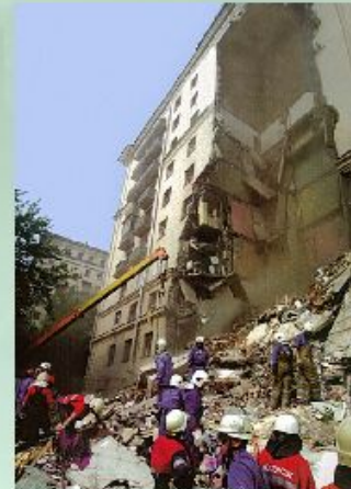
Последствия взрыва газа в жилом доме.
