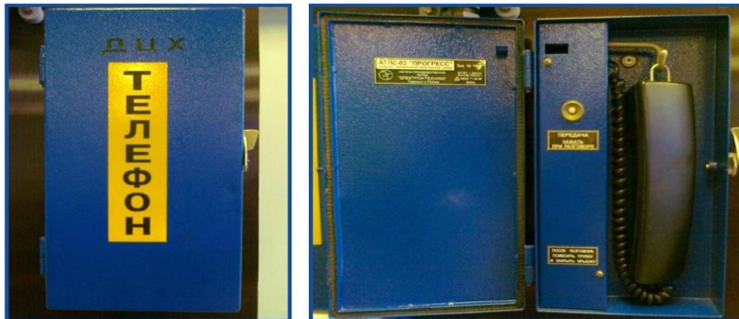
Телефон тоннельной связи
