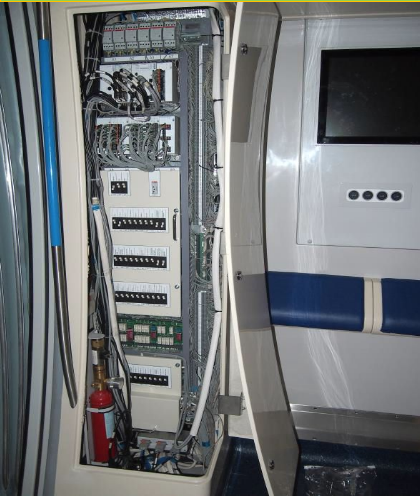
Шкаф (задний) правый - для размещения электрического оборудования.
