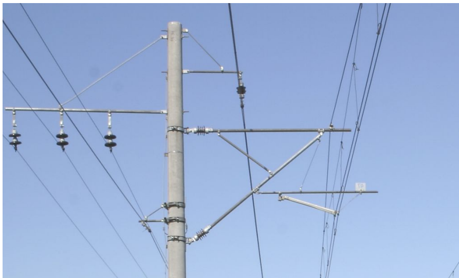
КС постоянного тока напряжением 3 кВ
