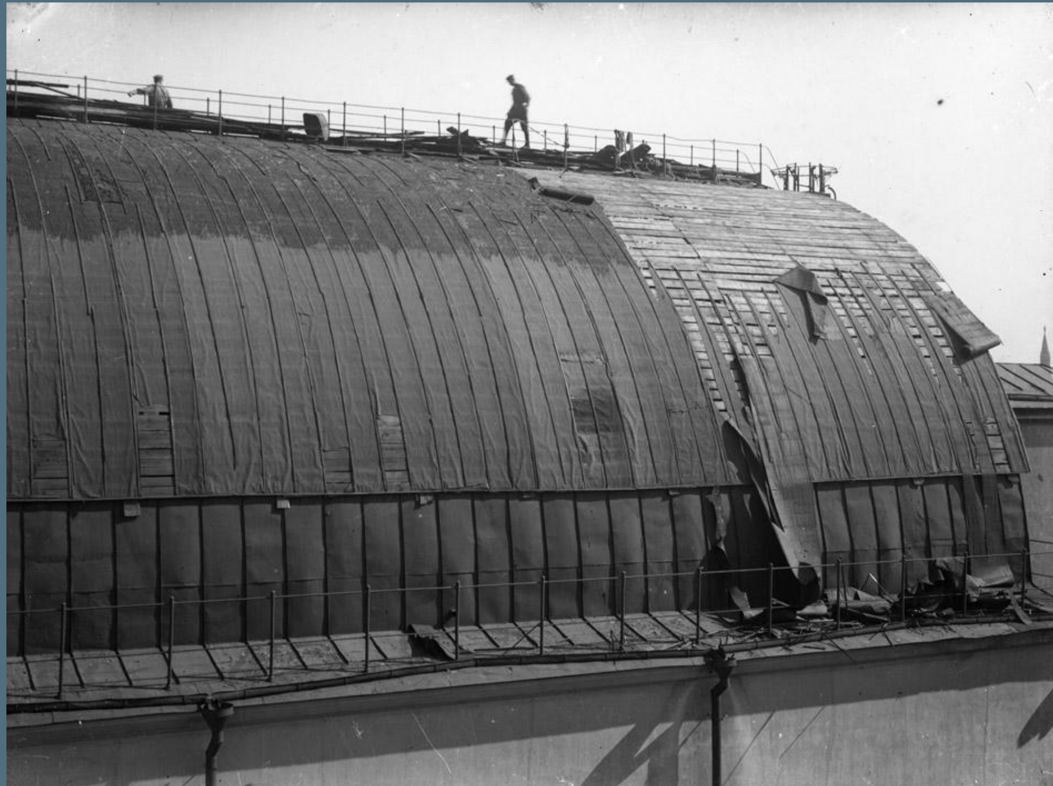
Крыша музея под временной кровлей из досок и толя. 1944
