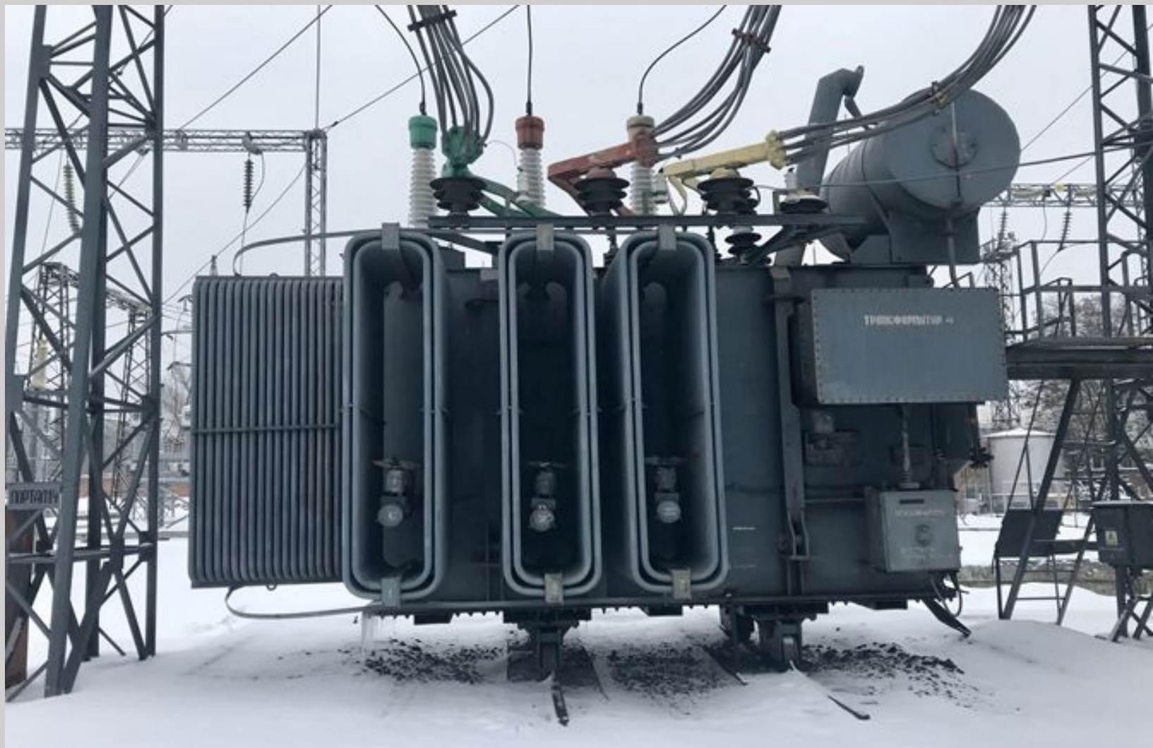
Трансформатор ТДНГ 40500\115\38,5\6,6 кВа
